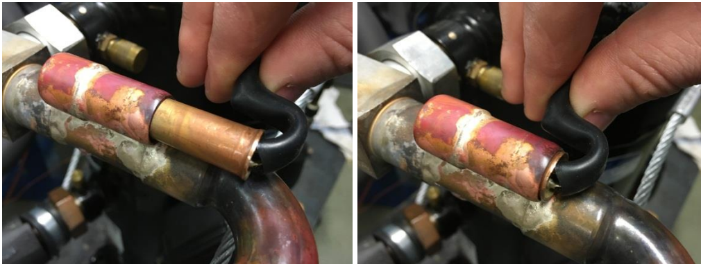
Figure 6: Tube de cuivre court brasé sur la tuyauterie de refoulement pour loger le bulbe de la vanne DTC
